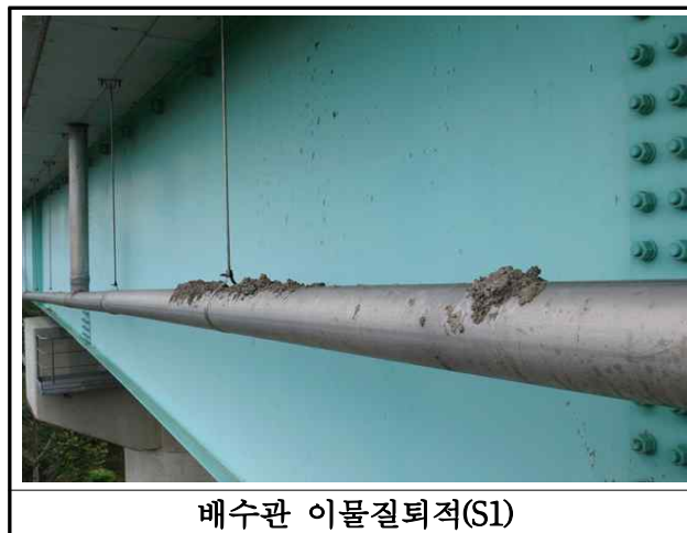
【사진 3.2.20】 배수시설 손상현황
