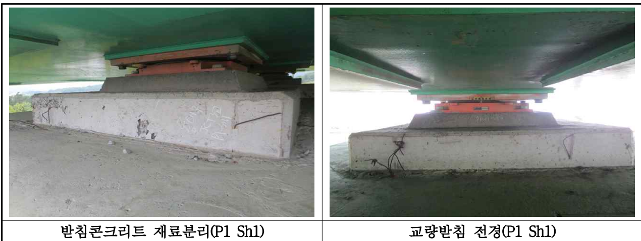
【사진 3.2.12】 교량받침 손상현황
