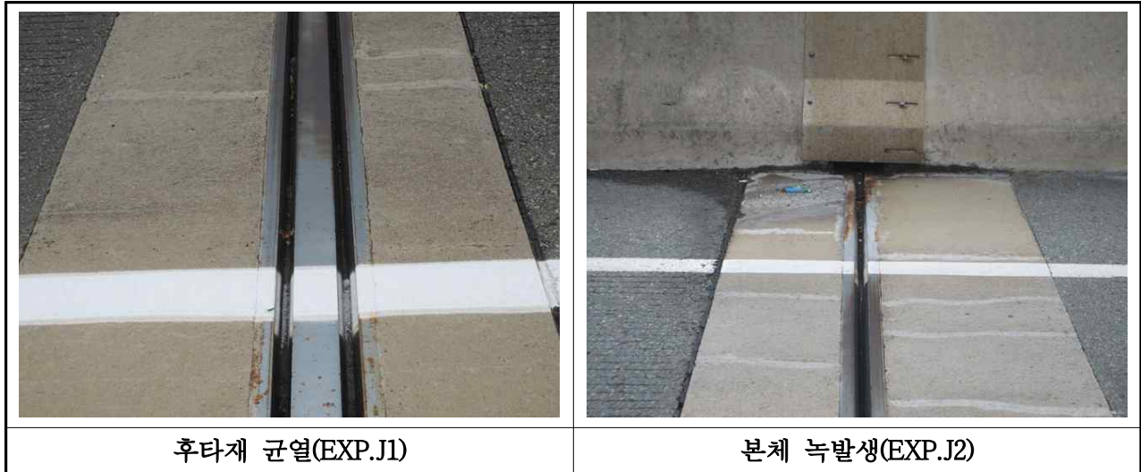
【사진 3.2.15】 신축이음장치 손상현황
