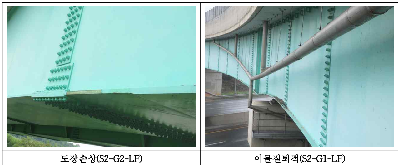
【사진 3.2.5】 거더 외부 손상현황
