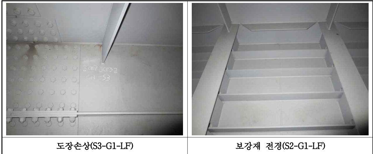
【사진 3.2.4】 거더 내부 손상현황
